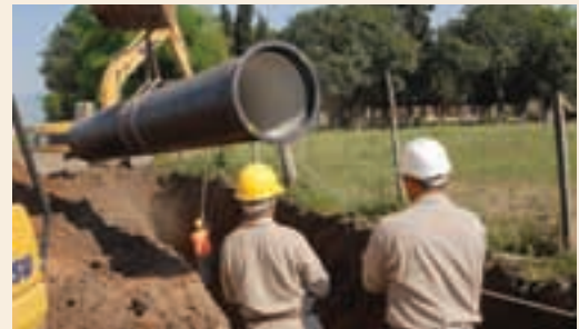
▲ Técnicos inspeccionan la colocación de la tubería del acueducto de Lomas de Tafí
