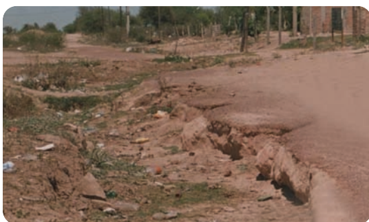
▲ Calle erosionada por acción de la lluvia antes de ser pavimentada
