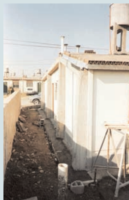
Reacondicionamiento de junta de elemento premoldeado en una vivienda de la ciudad de Palpalá, Jujuy.
