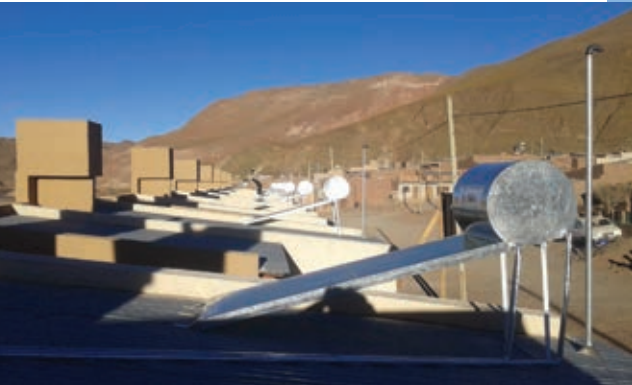
▲ Termotanques solares ya instalados en viviendas próximas a entregarse en Susques, Jujuy
