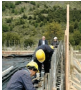
▲ La Planta Potabilizadora tendrá una capacidad de producción inicial de 9.000 m 3 por día
