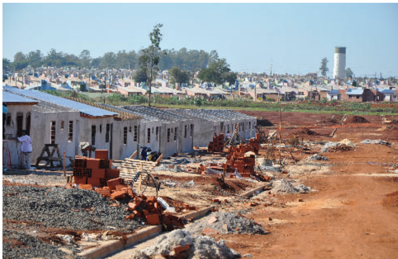
▲ Viviendas dignas (con infraestructura y servicios) se construyen al sur de Posadas para las familias de los relocalizados de asentamientos irregulares.
