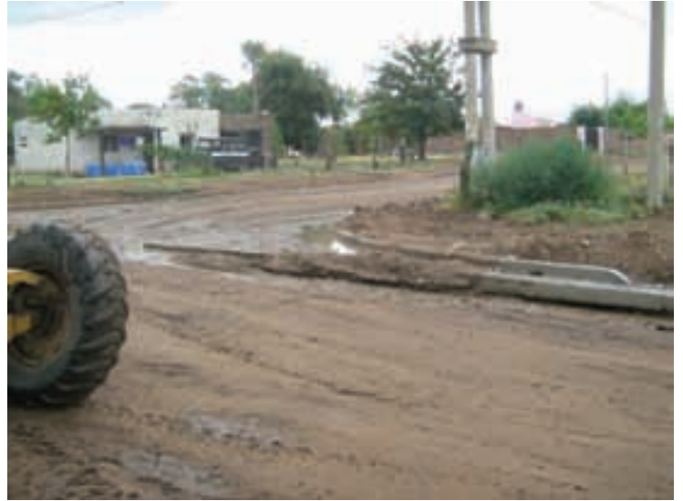
Obra Zona Norte Germinal – Santa Rosa. Cordón cuneta calle Alemania y Stieben ▲
